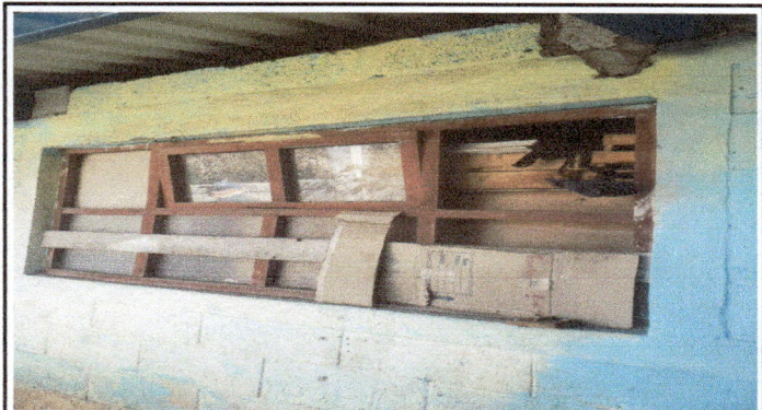
FOTO 4: VENTANAS DETERIORADAS POR EL TIEMPO.
