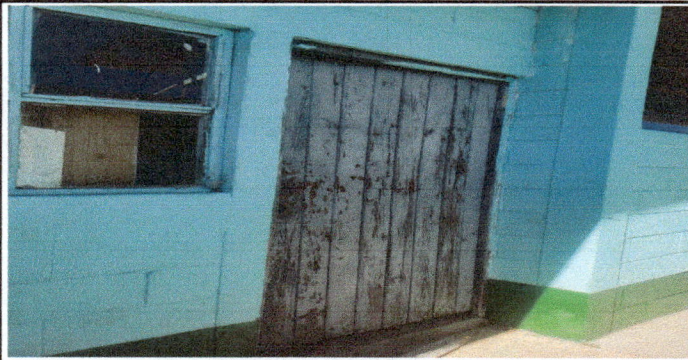
FOTO 5: LA PUERTA ACTUAL ES DE MADERA Y EN MAL ESTADO.
