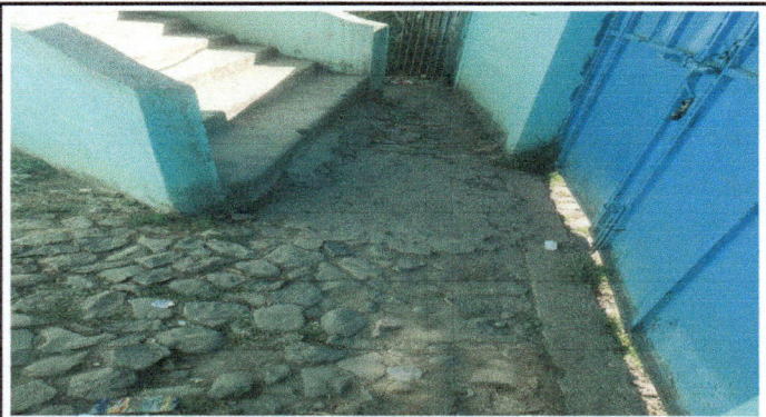
FOTO 3: EN LA ENTRADA, EL PISO ESTA EN MAL ESTADO.
